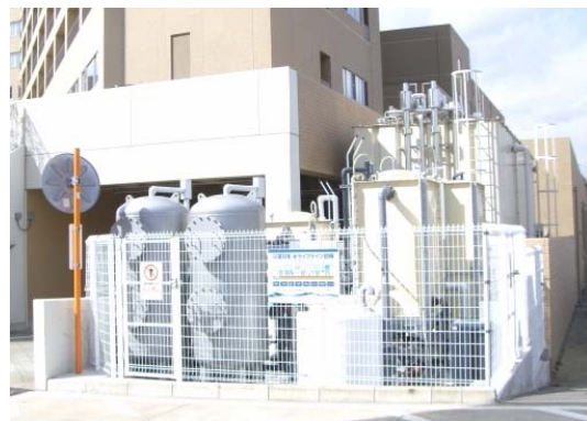
【国立病院機構水戸医療センターに設置された 地下水プラント】 東日本大震災の際プラントが活躍
