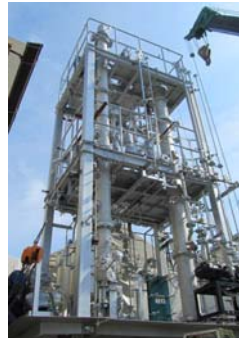
【HIDiC（内部熱交換型蒸留塔）】 神戸大学リファイナリーセンターに納入
