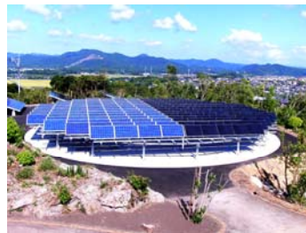
【太陽追尾型太陽光発電システム】
