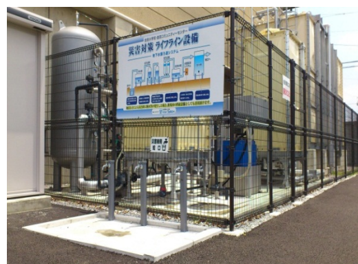
【近江八幡市 金田小学校・金田コミュニティセンターに 2012 年 3 月プラント納入】
