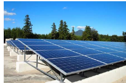
太陽光発電設備
