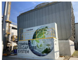
CO 2 回収装置
