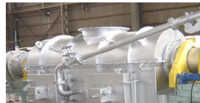
写真②炭化処理装置過熱水蒸気の特性を廃棄物有害物の処理に応用する HAS
