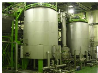
廃 LLC 処理設備
