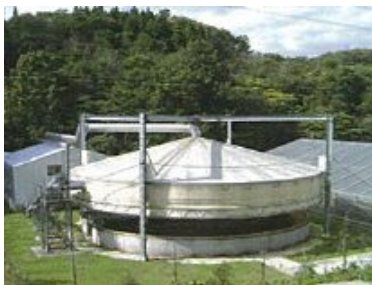
バイオガスプラント (バイオマス資源とLP Gの混合利用研究)
