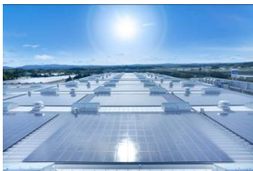
福島矢吹工場の太陽光発電設備
