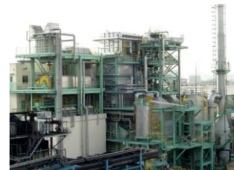
八潮工場のバイオマス焼却発電設備
