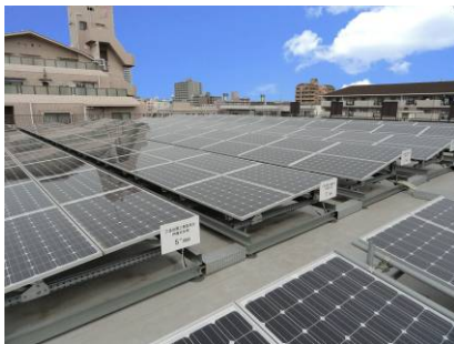
会社屋上における太陽光発電パネル
