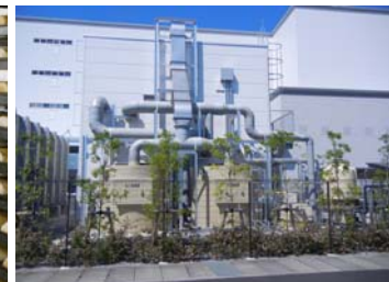
【高崎工場の最新鋭排水処理施設】
