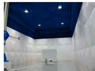
会津工場新建屋内 電波暗室
