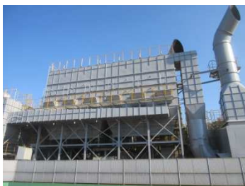
環境対策設備
